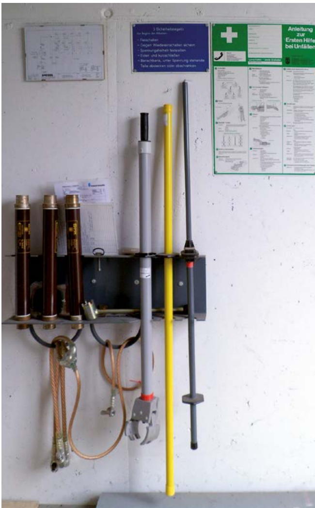
Bild 5-1: Einrichtungen für sicheres Arbeiten in elektrischen Anlagen sind bereitzustellen und zu benutzen
