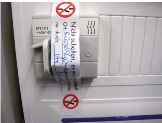
Bild 5-11: Gegen Wiedereinschalten gesicherter Hauptschalter
