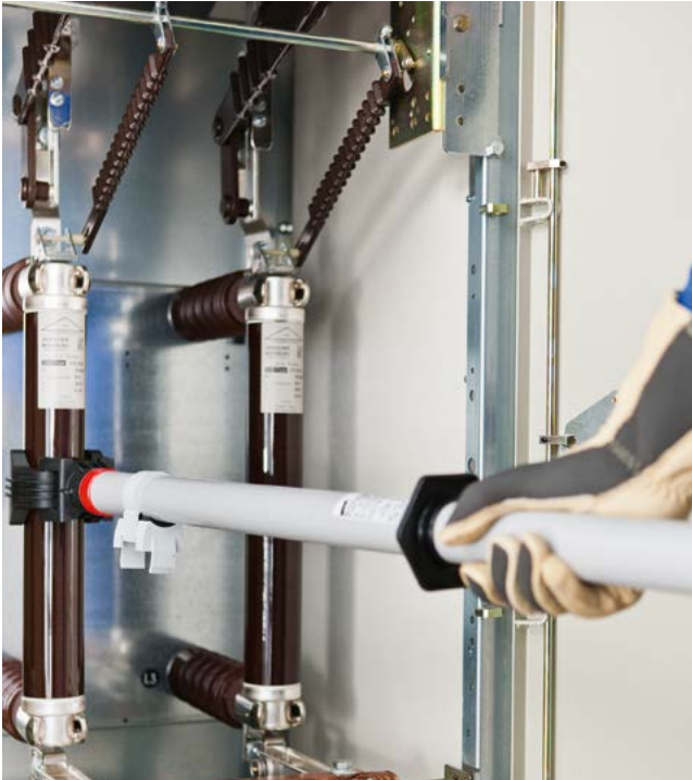
Bild 5-9: Wechsel einer HH-Sicherung mit vorschriftsmäßiger Sicherungszange
